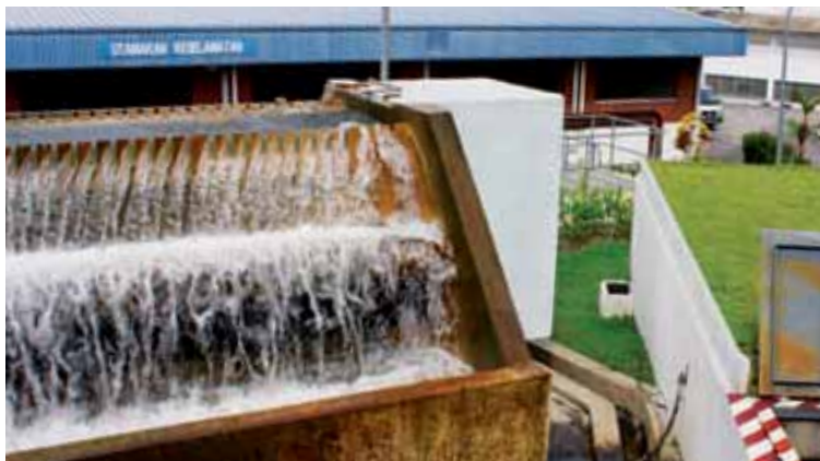
◀ Wangsa Maju WTP aerator
